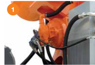
1 Am Trommelgetriebe angeschlossene Wasserpumpe.
