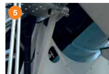
5 Bloqueo de seguridad del tambor para mantenimiento y cubierta de plástico.
